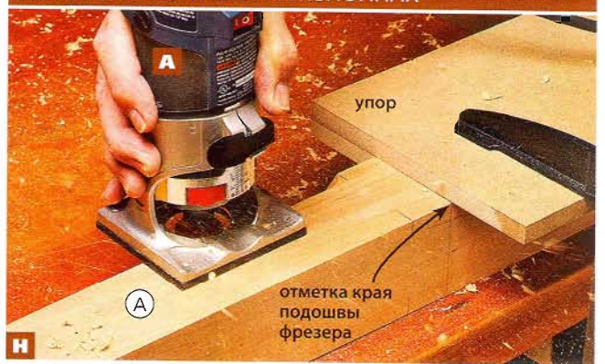
Н Для фрезерования фасок на колоннах А удобно использовать кромочный фрезер. Чтобы получить аккуратные фаски одинаковой длины, закрепите на заготовке упор.
